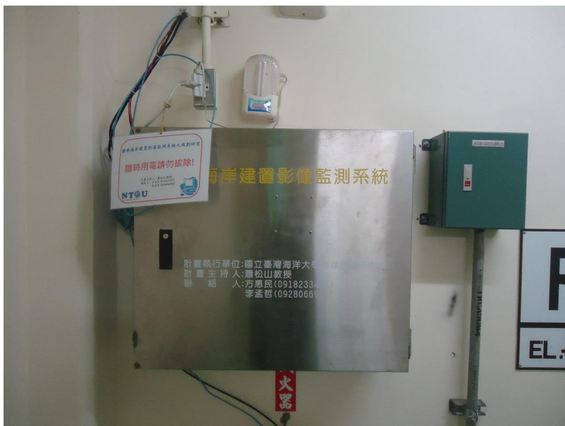
圖 3-15 觀測站主機機箱
