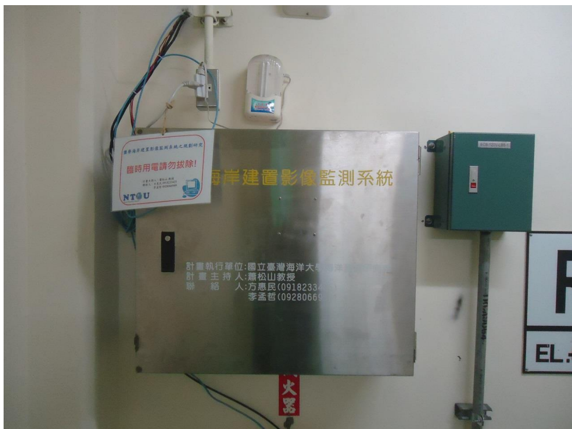
圖 3-15 觀測站主機機箱
