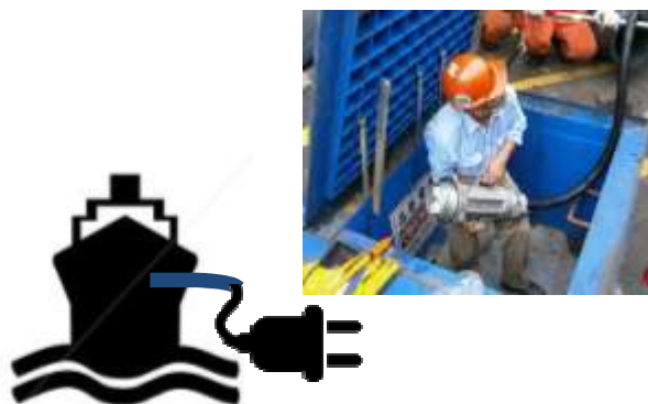
設置高壓岸電設施
