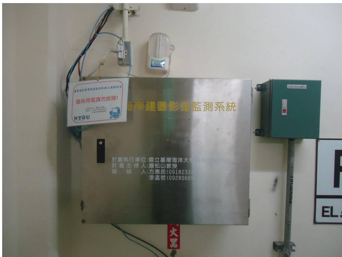
圖 3-15 觀測站主機機箱
