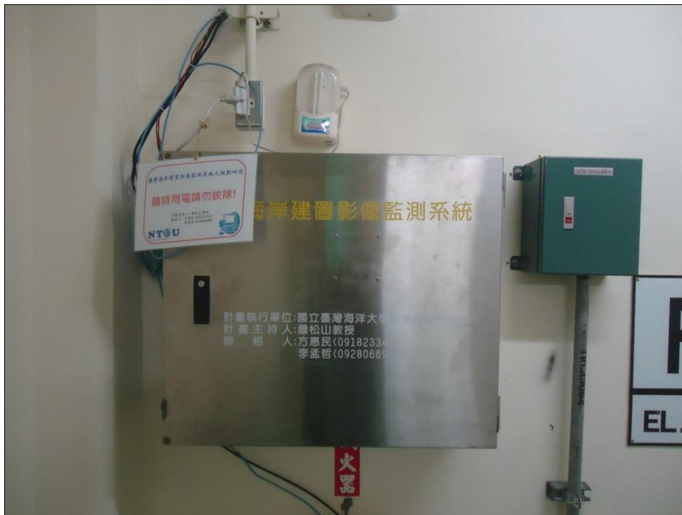
圖 3-15 觀測站主機機箱
