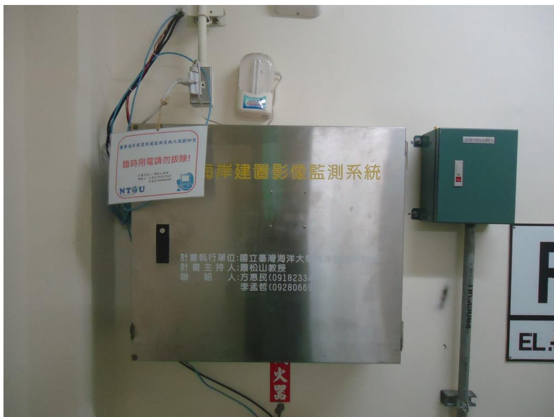
圖 3-15 觀測站主機機箱
