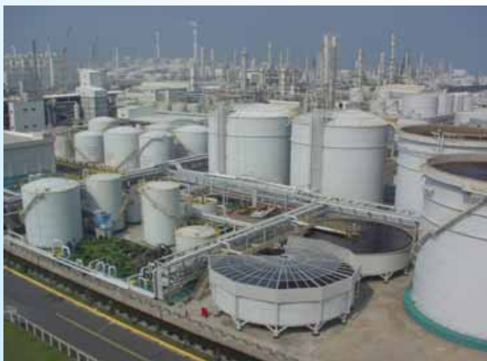
南亞麥寮廢水處理場
