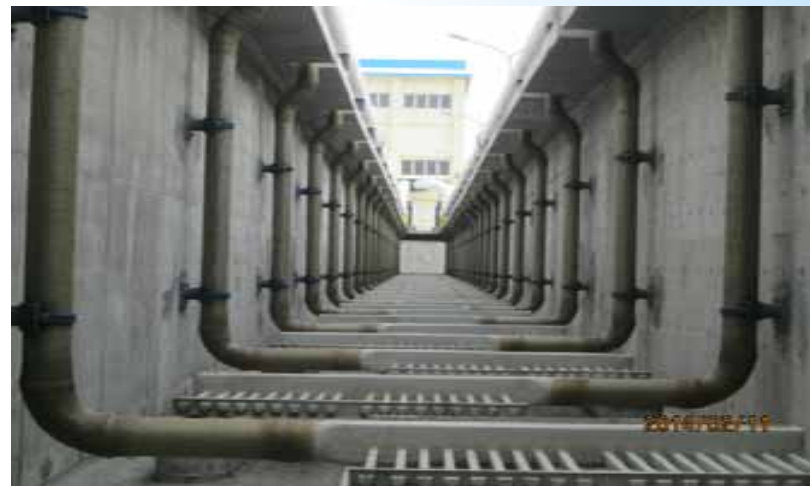
裝設有1,056個沉水式曝氣器
