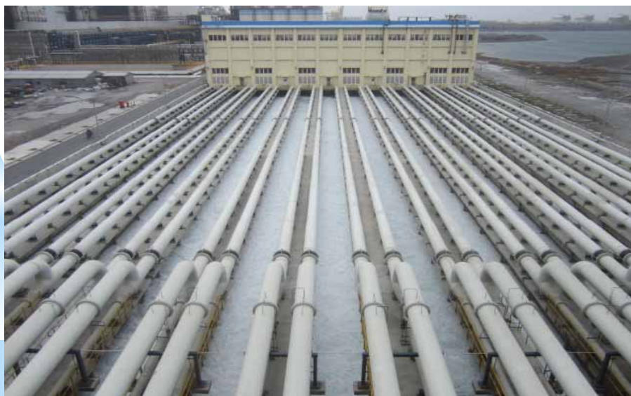
曝氣主管及排放渠道
