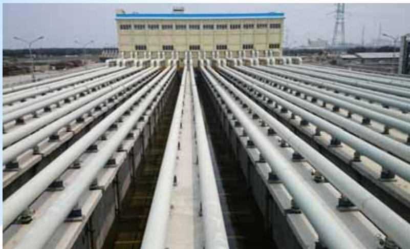
曝氣管配管總長度約10.2公里
