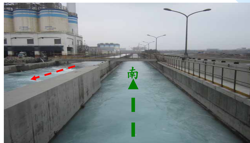
曝氣池回流渠道(出口段)
