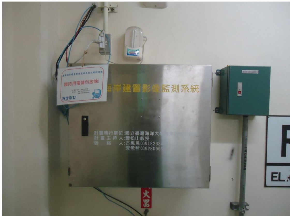
圖 3-15 觀測站主機機箱
