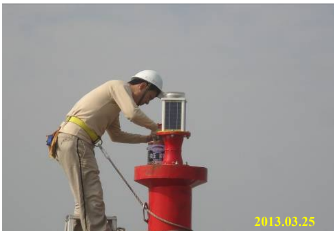
照片 1.1-5 鹿港區 101 年度公共設施維護工程(C10007) 南攔沙堤導航燈具安裝完成查驗
