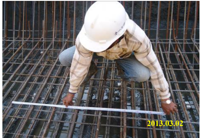
照片 1.1-2 線西區相關產業區公共設施工程(A10006) 排水工程 305 箱涵底版鋼筋施工查驗
