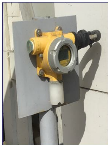
氨水儲槽旁設置氨氣偵 測器
