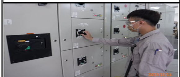
說明：安全防護班_關斷幫浦電源
