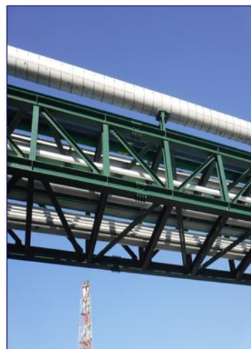
廢水以管線密閉方式輸 送
