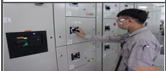
說明：安全防護班_關斷幫浦電源
