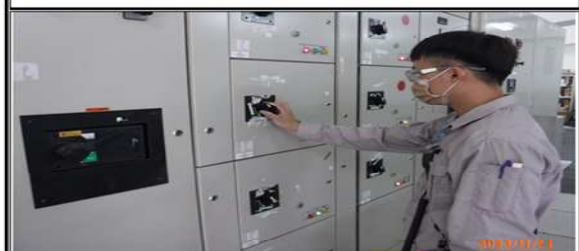
說明：安全防護班_關斷幫浦電源
