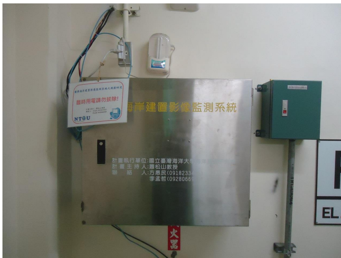
圖 3-15 觀測站主機機箱
