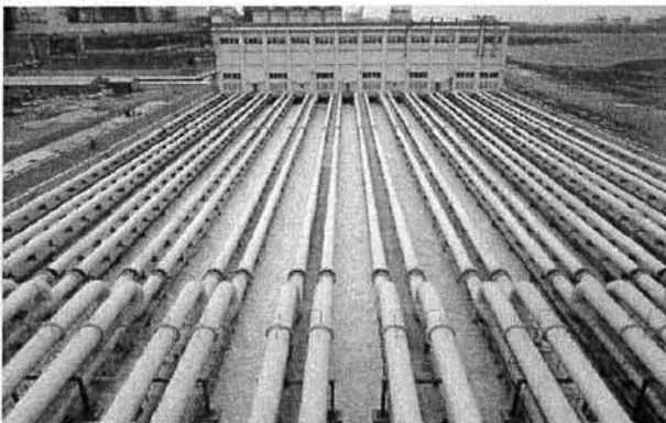
曝氣主管及排放渠道
