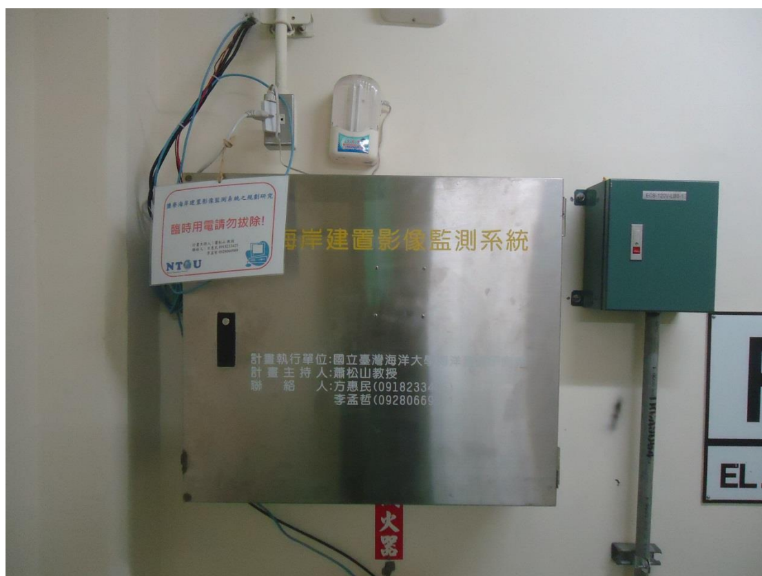
圖 3-15 觀測站主機機箱
