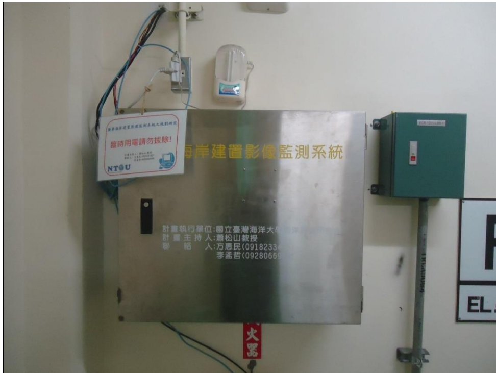
圖 3-15 觀測站主機機箱
