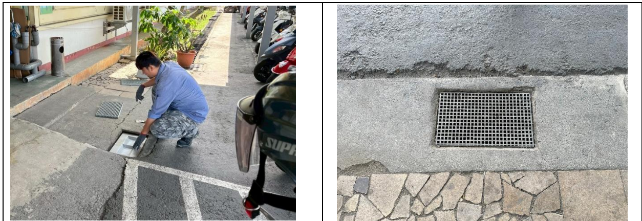
高雄市創新格柵板水溝蓋
