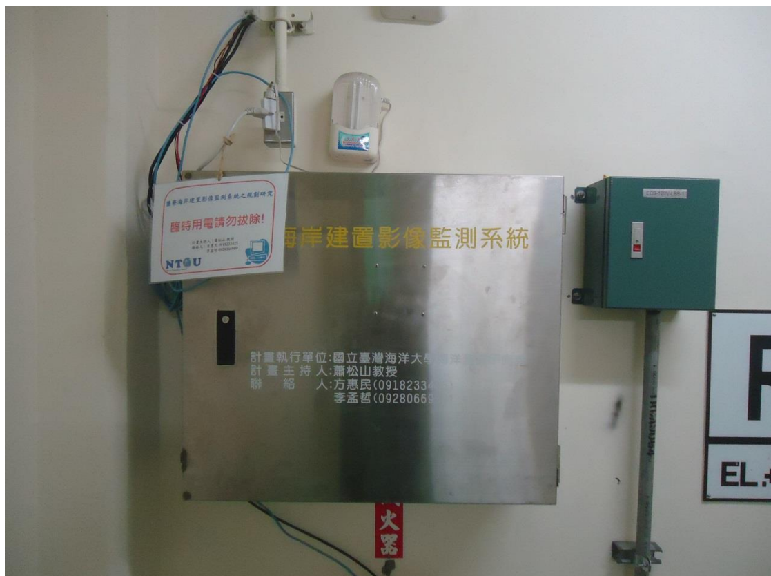
圖 3-15 觀測站主機機箱
