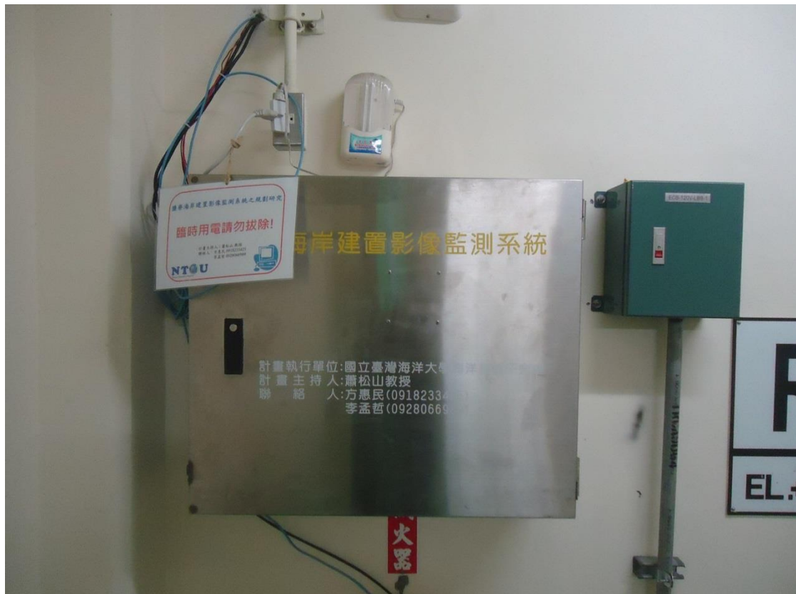
圖 3-15 觀測站主機機箱
