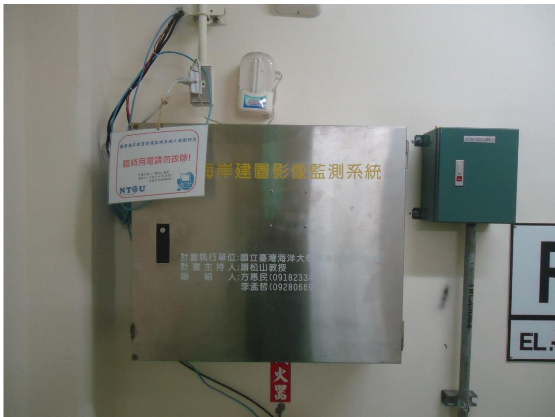
圖 3-15 觀測站主機機箱
