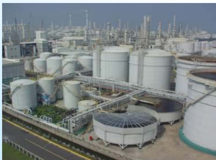
南亞麥寮廢水處理場
