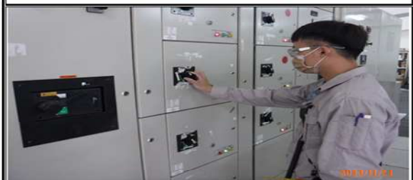
說明：安全防護班_關斷幫浦電源
