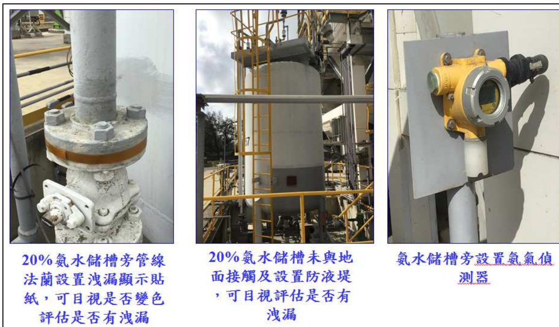
附圖一、長春集團麥寮廠區氨水儲槽污染防制措施
