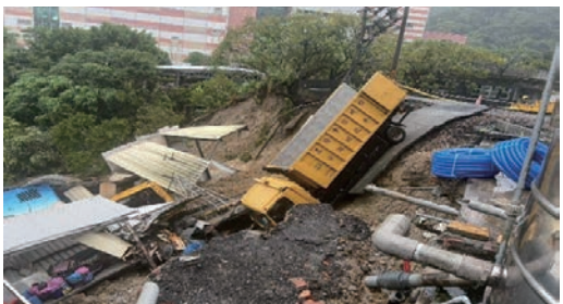
▲ 基隆市天外天焚化廠周邊地基崩塌
