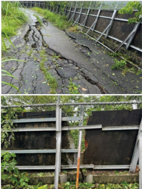
圖 76：上：臺南市楠西掩埋場聯外道路塌陷。下：場址擋土牆破損情形。
