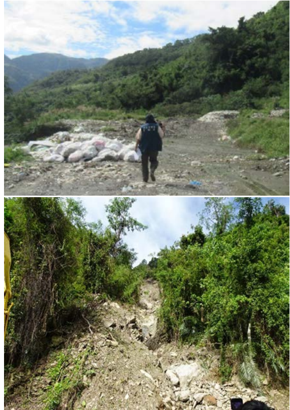
圖 77：上：臺東縣金峰鄉掩埋場掩埋面災損情形。 下：聯外道路災損情形。
