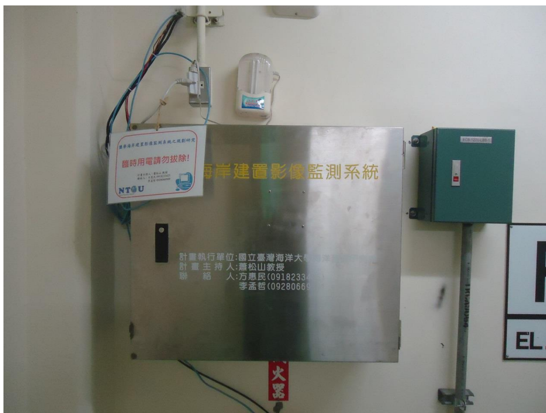
圖 3-15 觀測站主機機箱
