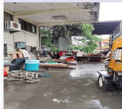
地板修繕前 下雨天積水
