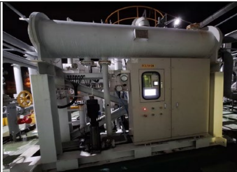
新設餘熱發電設備
