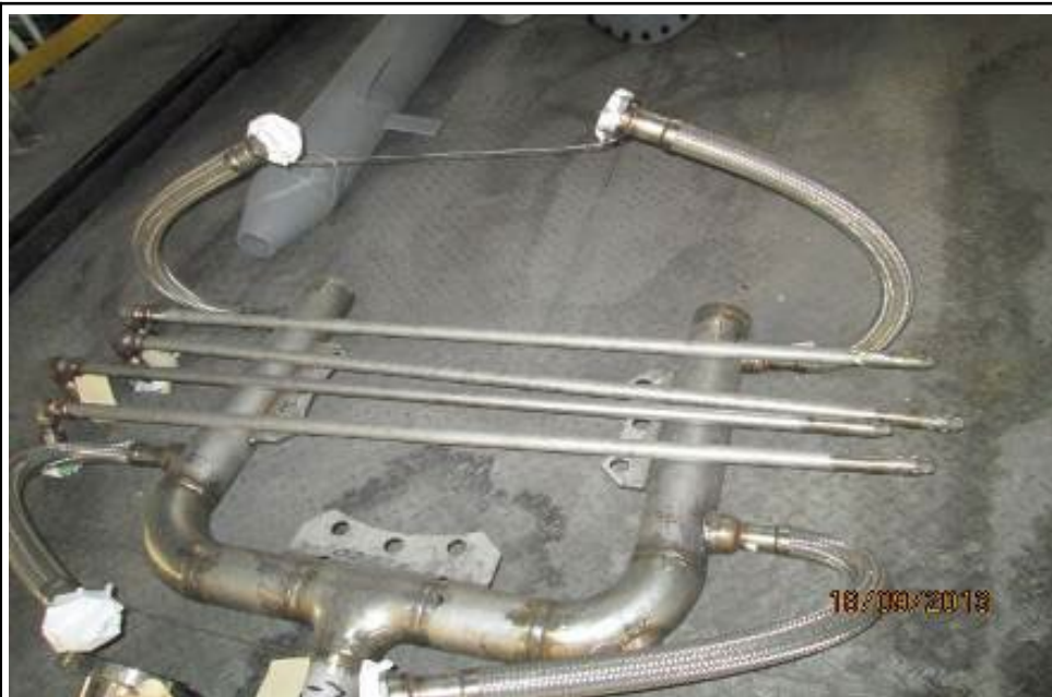
鍋爐改善(新增燃氣槍套件)
