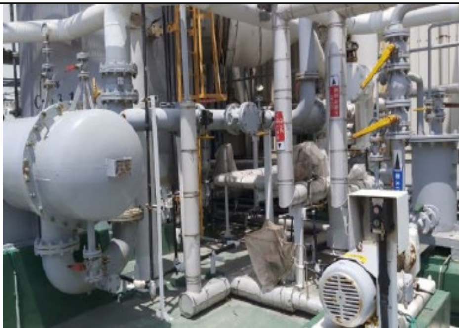
蒸汽冷凝水回收作為部分洗滌塔用水
