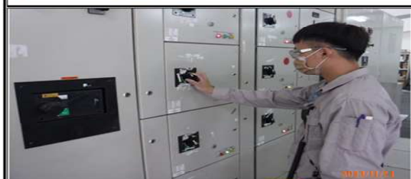
說明：安全防護班_關斷幫浦電源
