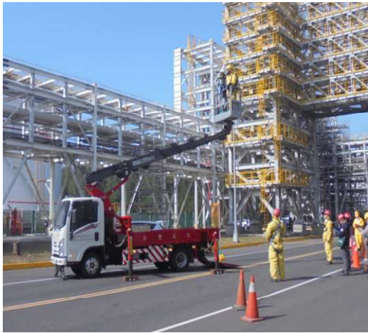
長春麥寮廠應變小組與 台塑公共管線組確認洩漏位置
