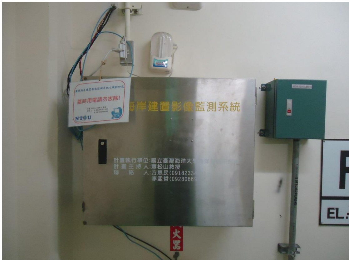
圖 3-15 觀測站主機機箱
