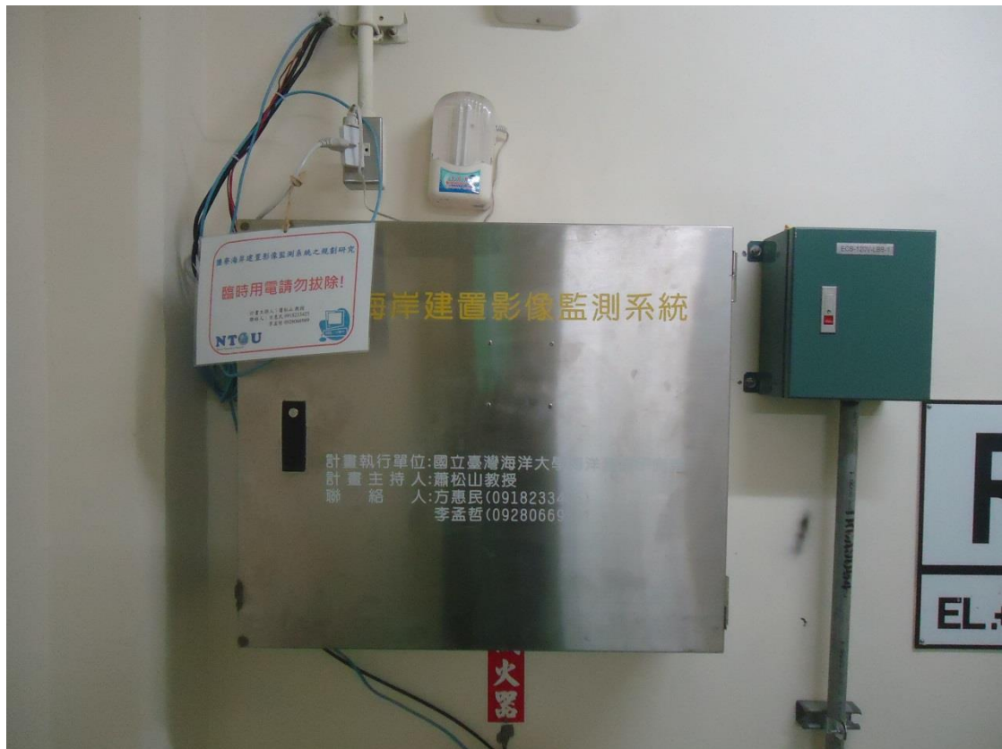
圖 3-15 觀測站主機機箱
