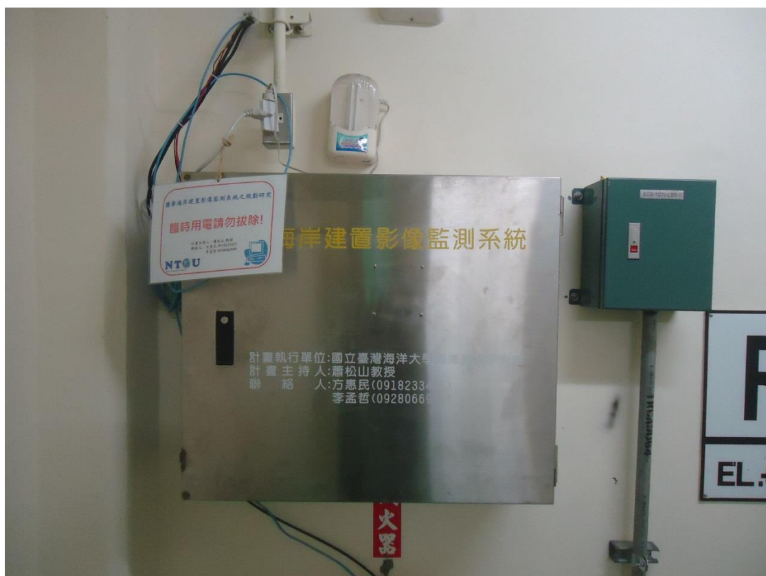
圖 3-14 觀測站主機機箱
