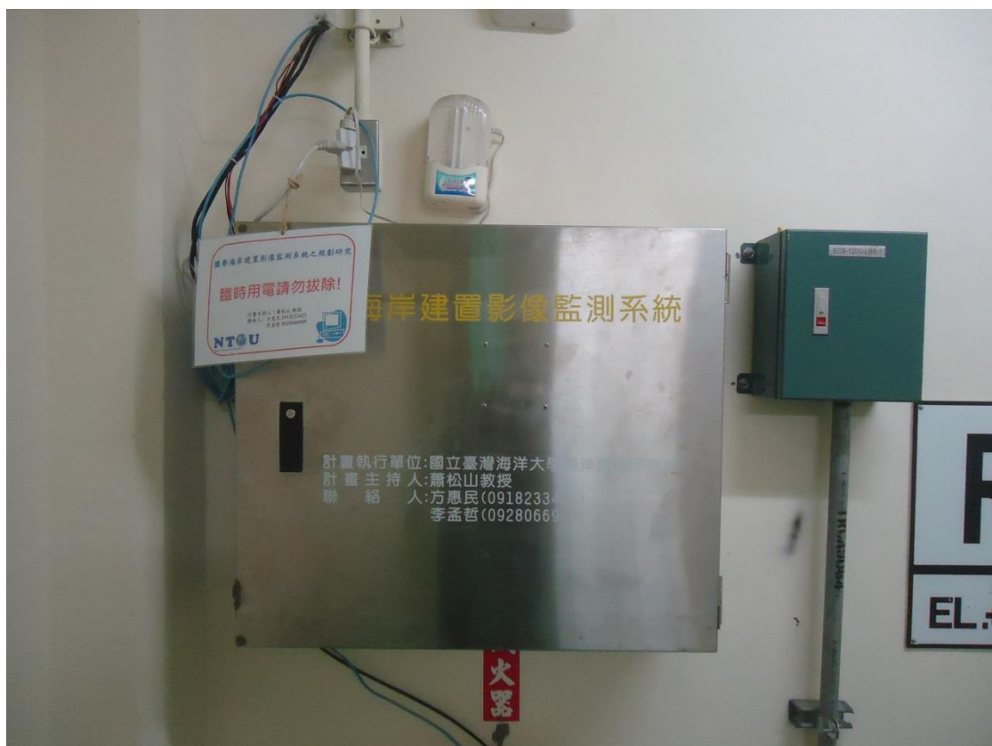
圖 3-15 觀測站主機機箱
