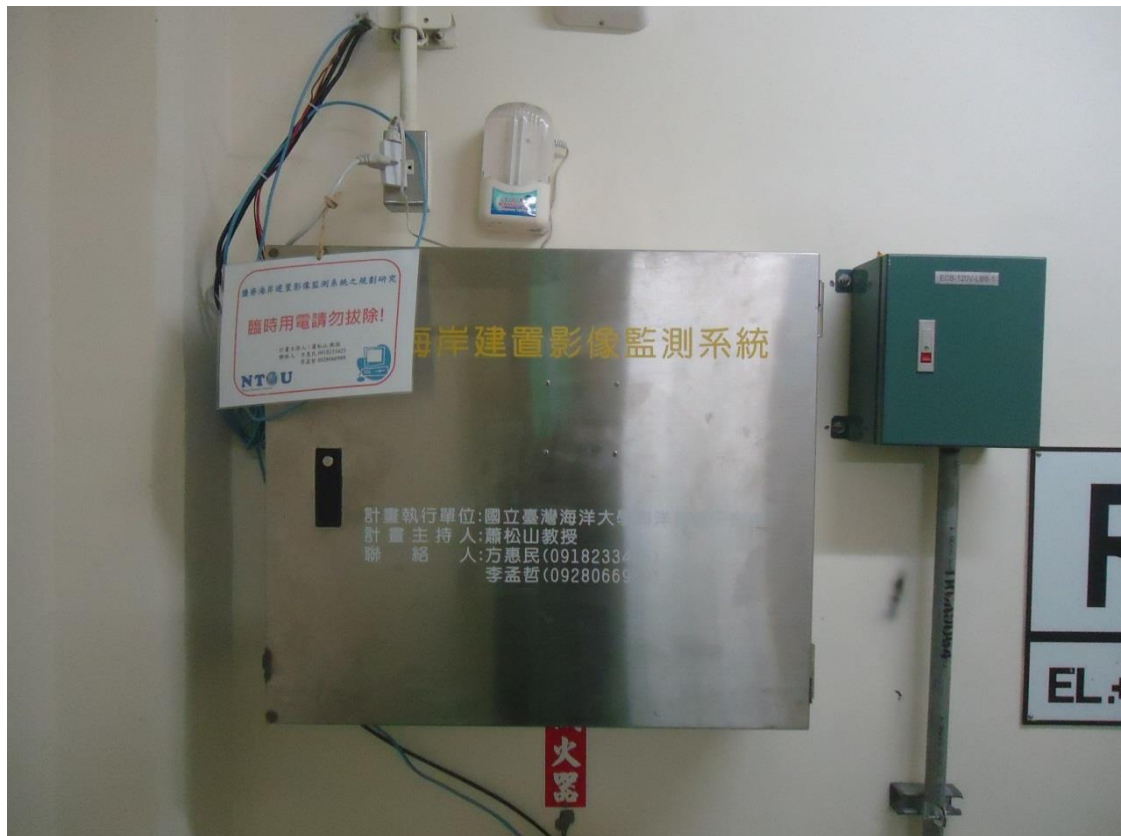
圖 3-15 觀測站主機機箱
