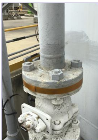
20%氨水儲槽旁管線 法蘭設置洩漏顯示貼 紙，可目視是否變色 評估是否有洩漏
