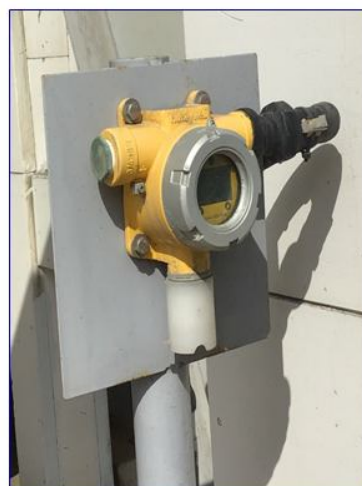
氨水儲槽旁設置氨氣偵 測器
