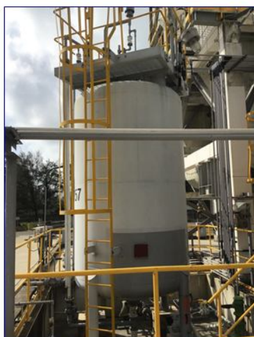
20%氨水儲槽未與地 面接觸及設置防液堤 ，可目視評估是否有 洩漏
