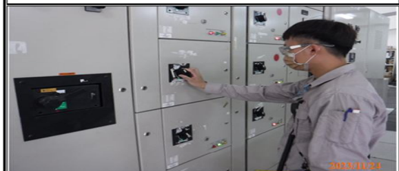
說明：安全防護班_關斷幫浦電源
