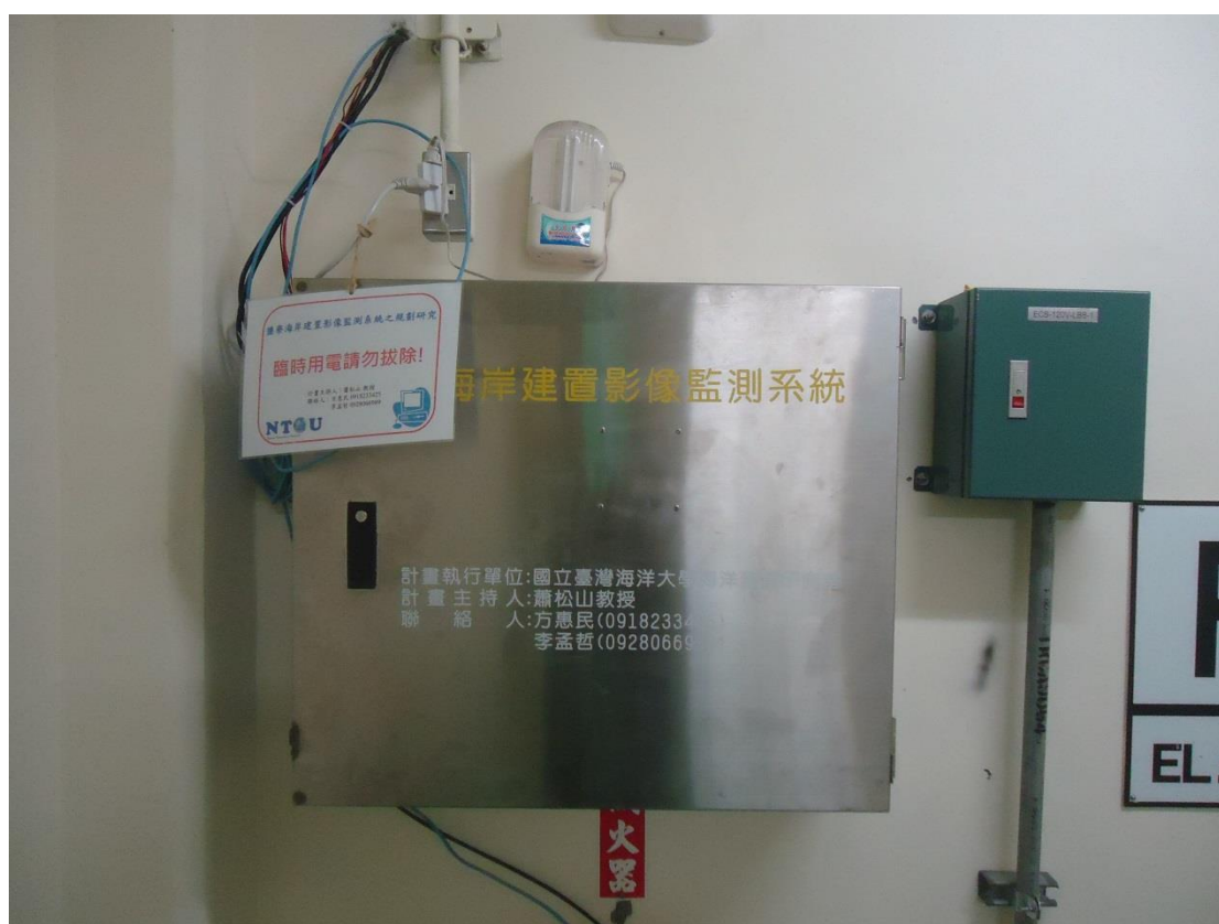
圖 3-15 觀測站主機機箱
