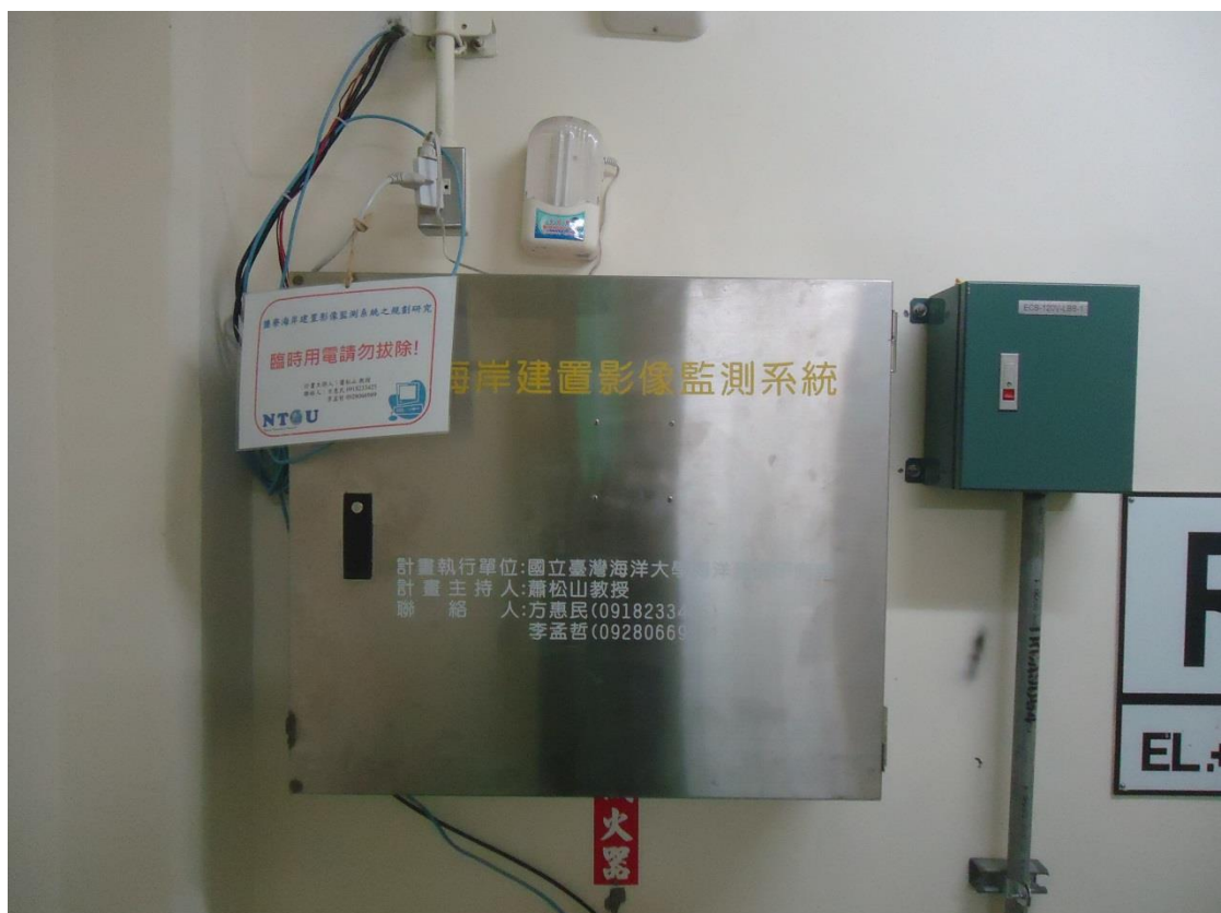
圖 3-15 觀測站主機機箱
