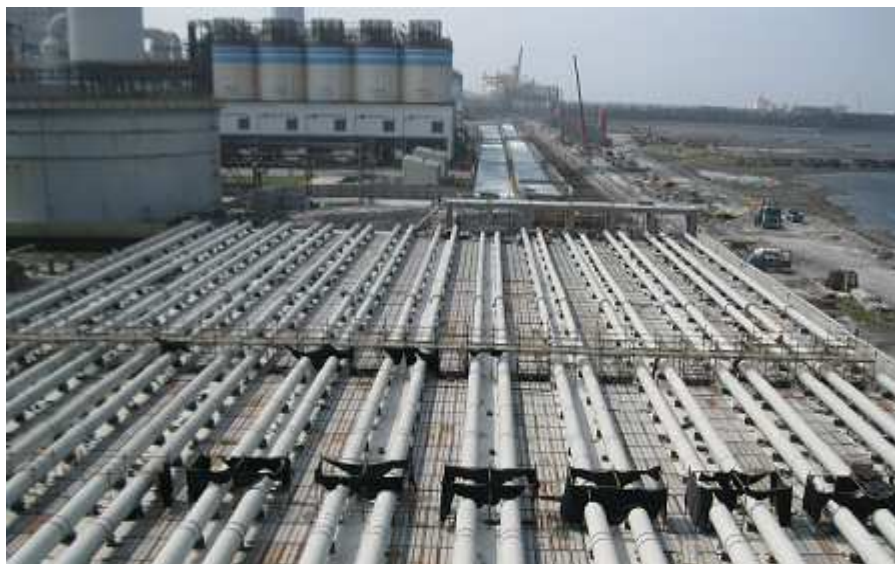
曝氣主管及排放渠道
