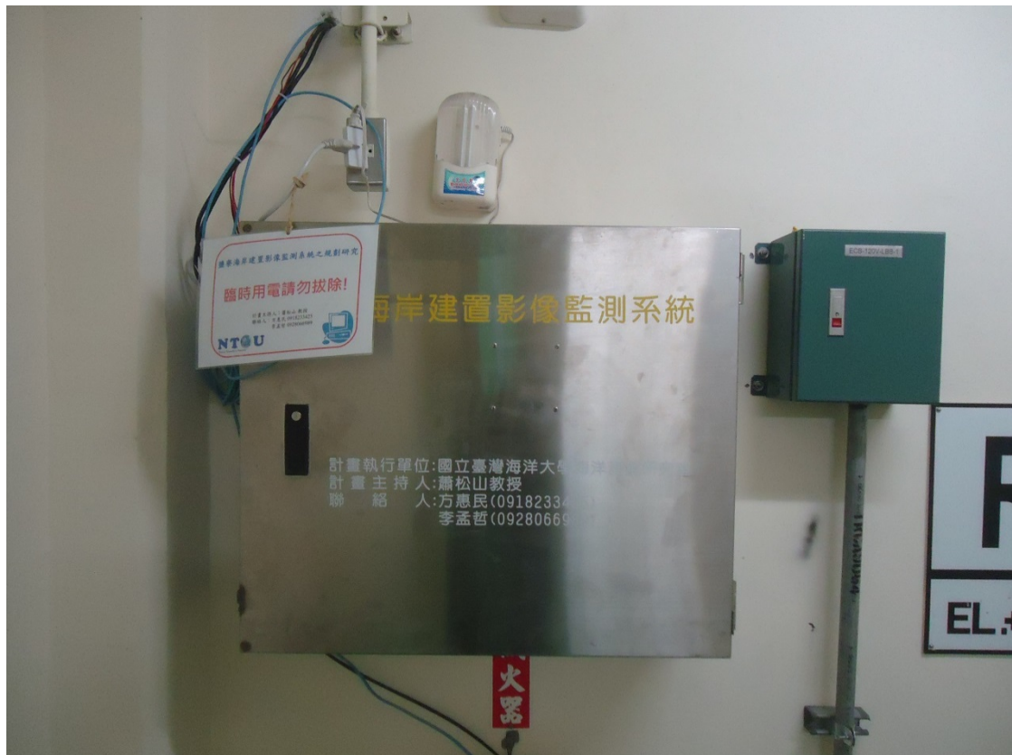
圖 3-15 觀測站主機機箱
