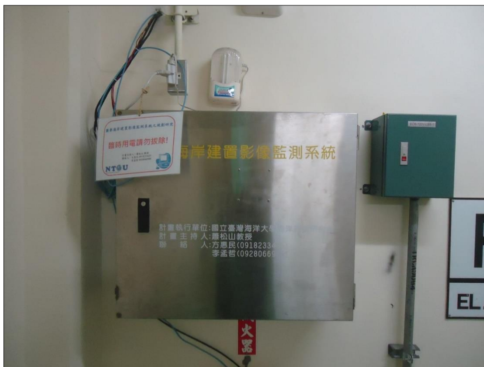
圖 3-15 觀測站主機機箱
