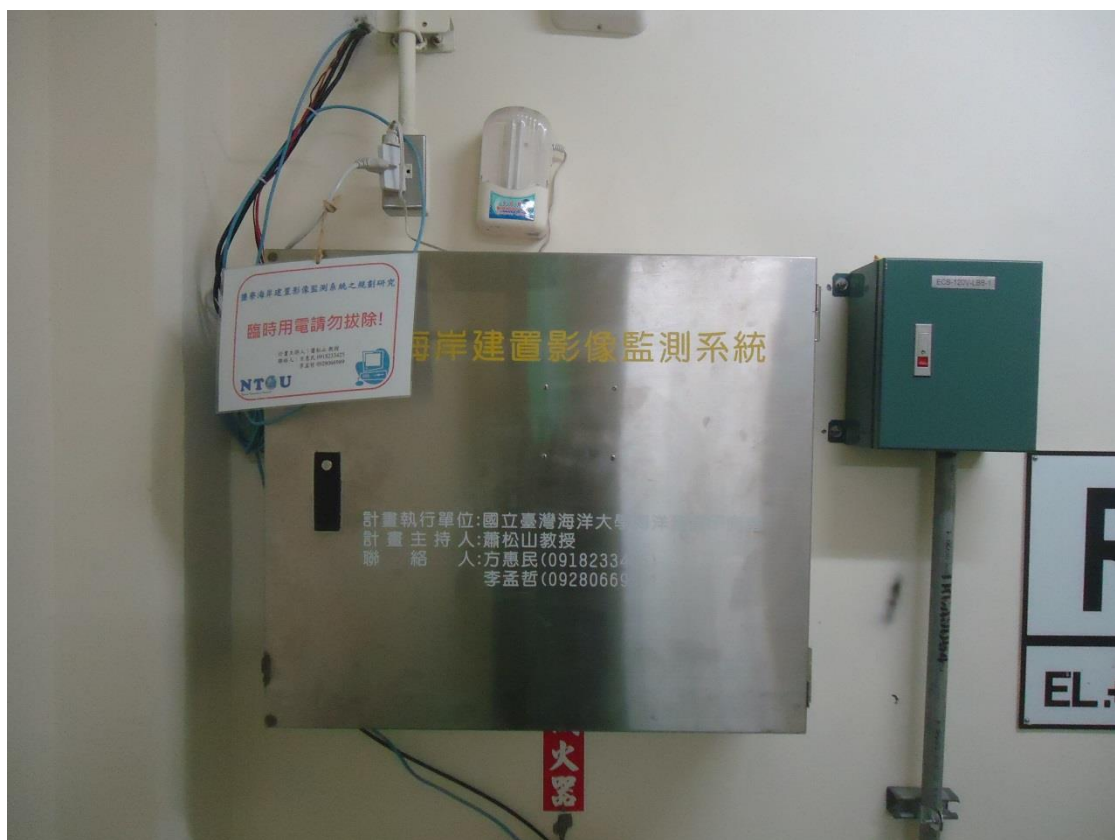
圖 3-15 觀測站主機機箱
