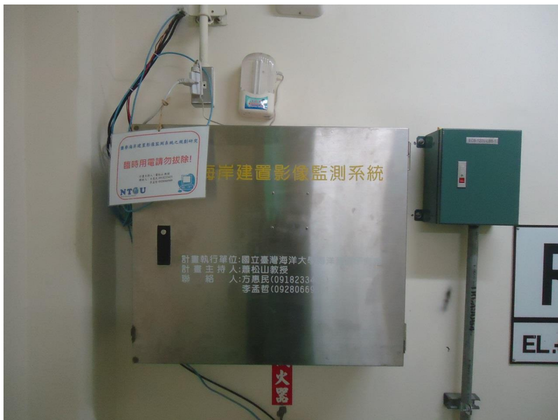
圖 3-15 觀測站主機機箱
