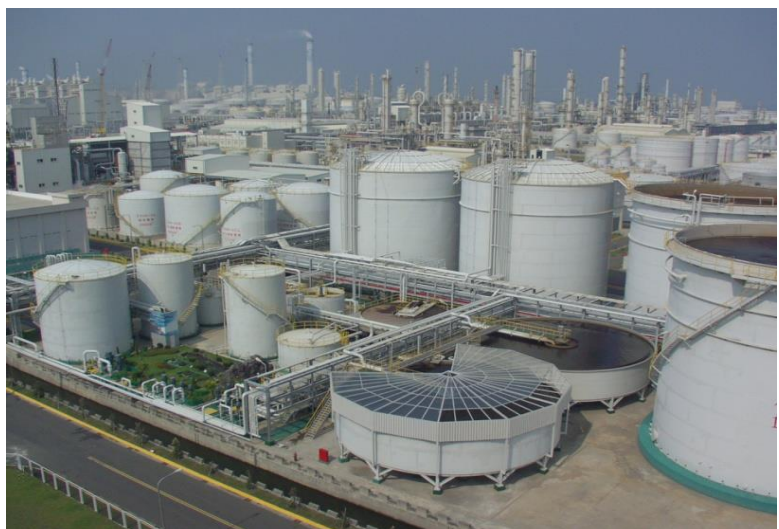
南亞麥寮廢水處理場
