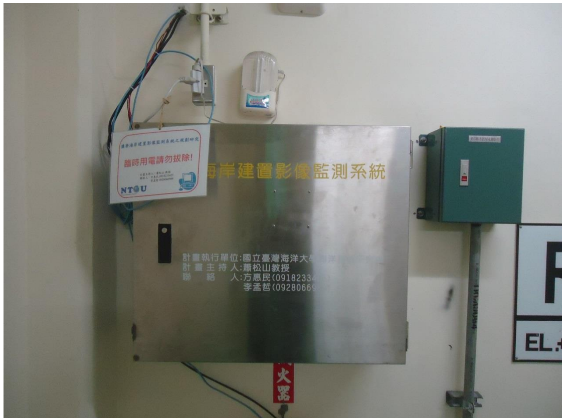
圖 3-15 觀測站主機機箱
