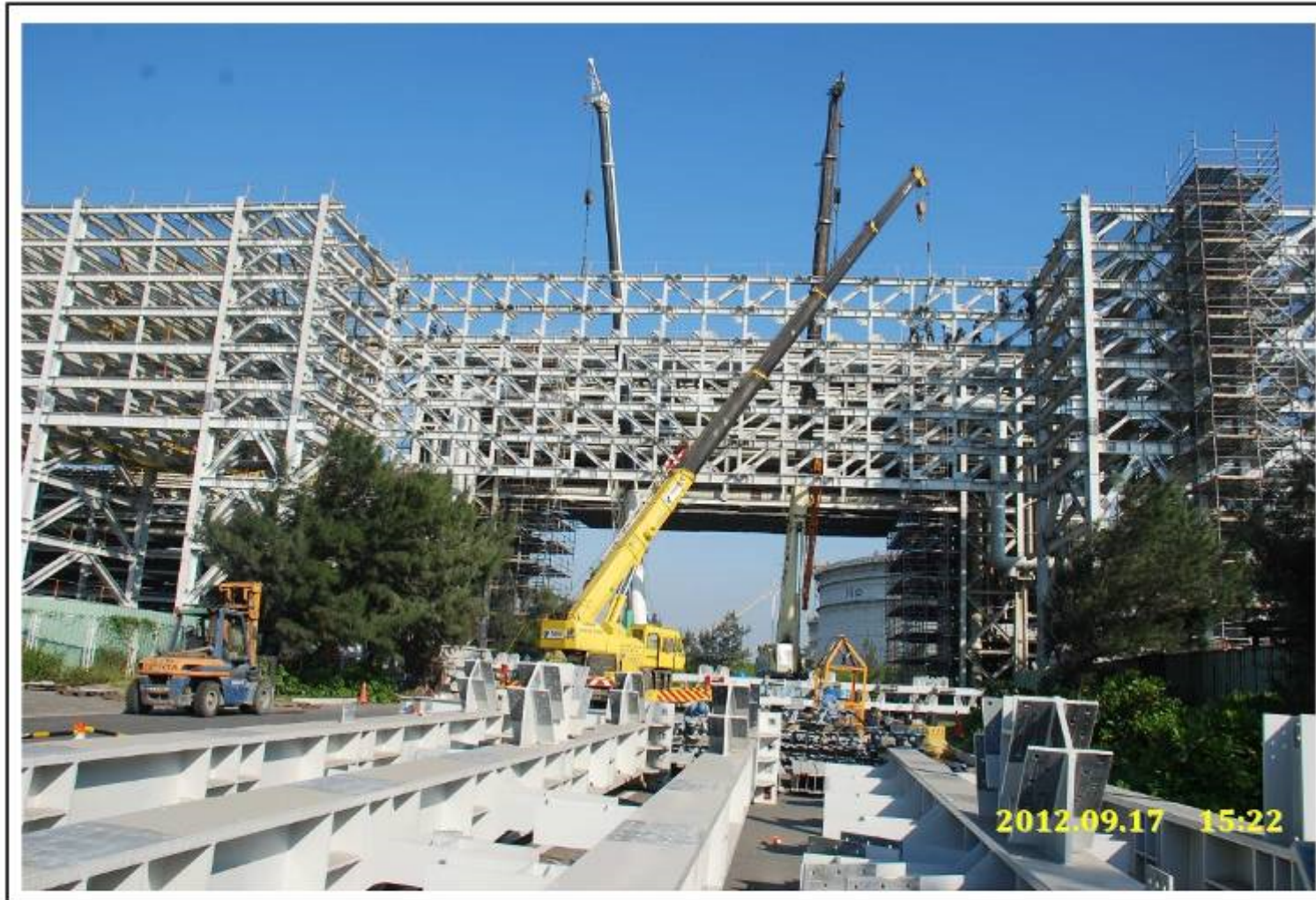
位於七道 A1a 段管段正進行跨越 5.2 路管架長 39M 高 24.5M，先於地面預組後再進行吊裝作業情形。 (101.9.17 由西南往東北拍攝)
