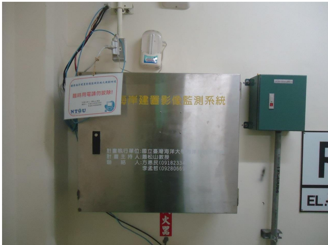
圖 3-15 觀測站主機機箱
