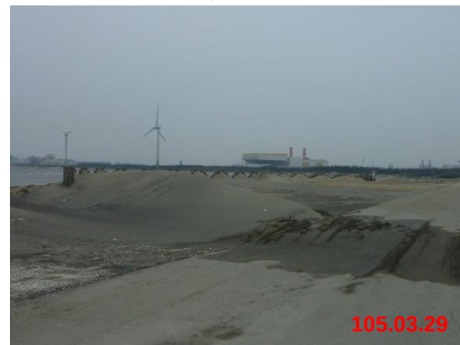
照片 1.3-15 海洋公園區賞鳥牆依然會有局部積砂情況。
