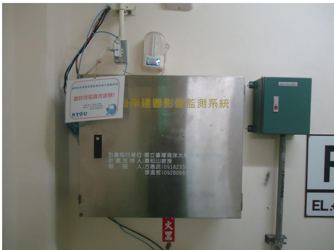
圖 3-15 觀測站主機機箱
