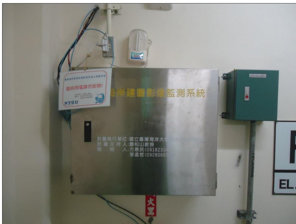
圖 3-15 觀測站主機機箱
