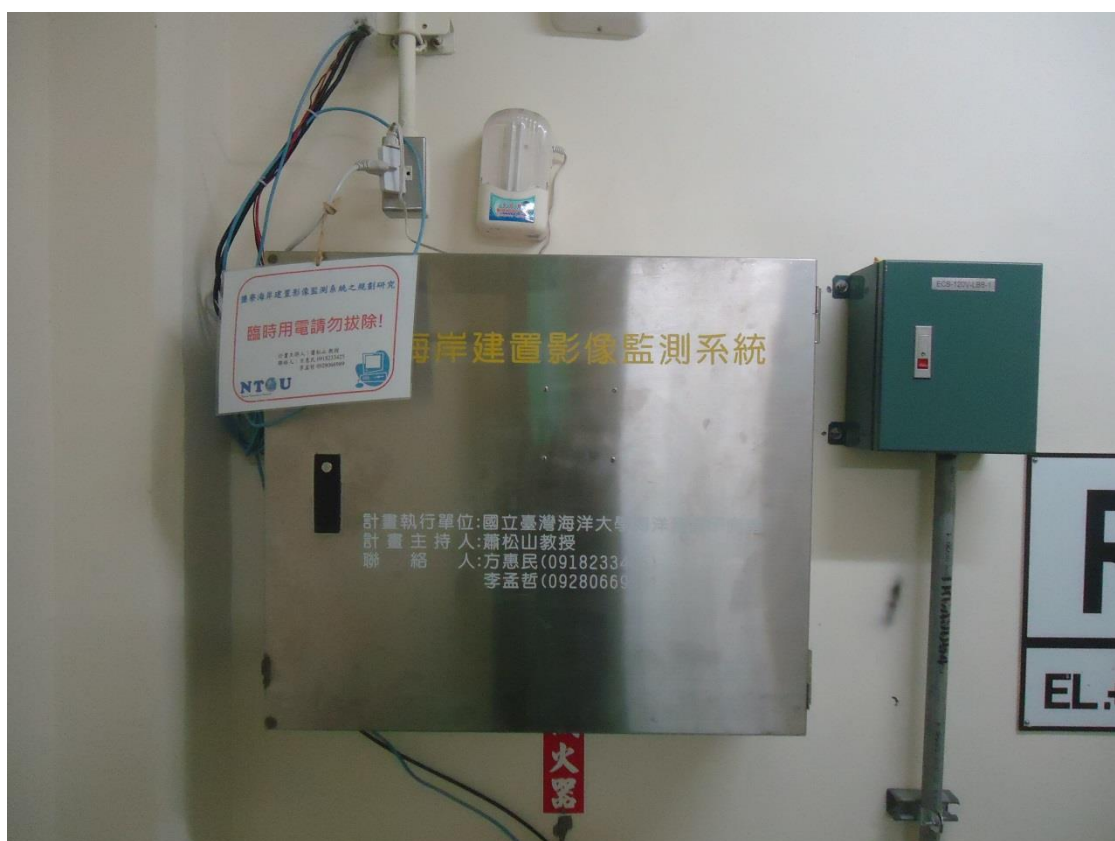
圖 3-15 觀測站主機機箱
