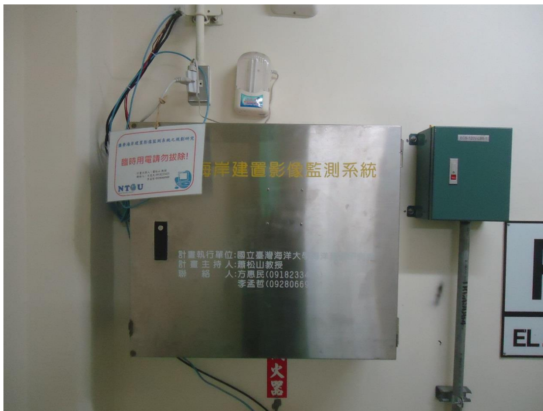
圖 3-15 觀測站主機機箱
