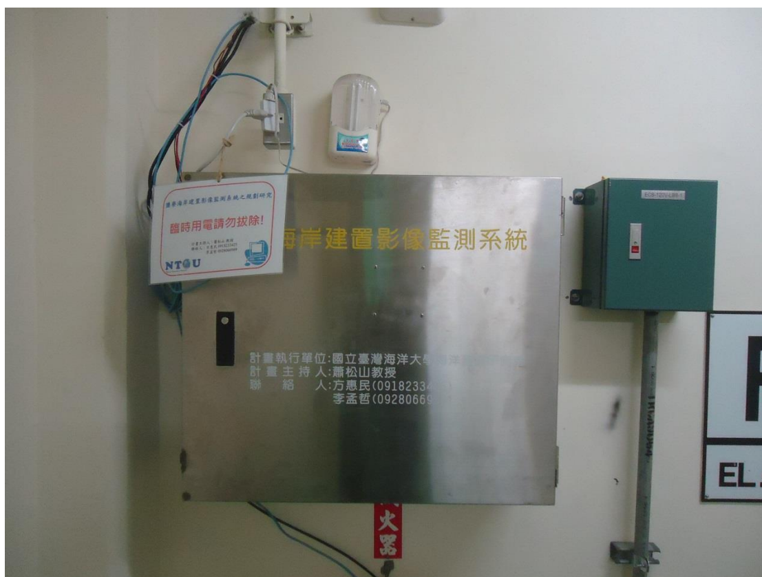
圖 3-15 觀測站主機機箱
